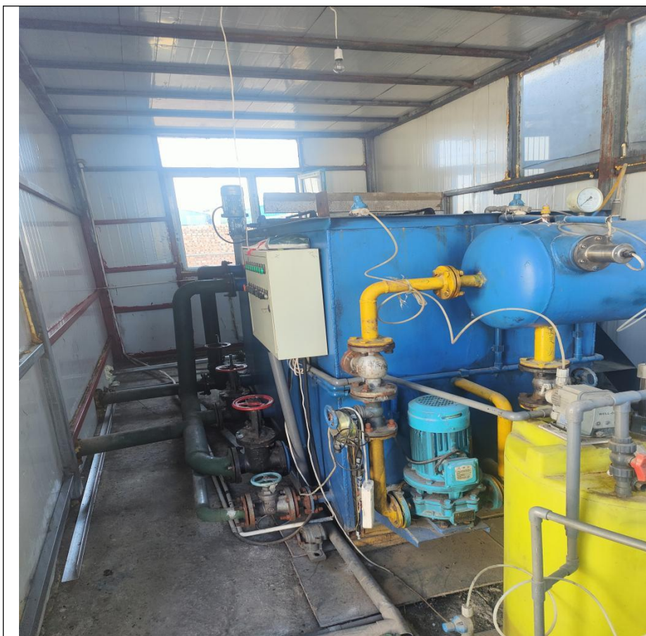
污水处理设施
